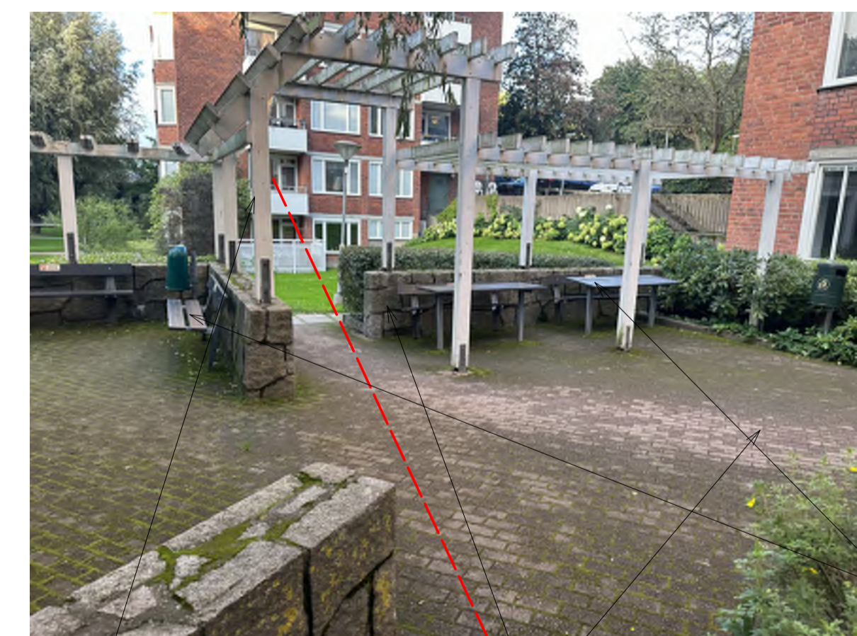
Demontering av befintlig stenmur och märktegel, till höger av röd markering på bild. Del av pergola och stenmur till vänster om röd markering på bilden ovan skyddas och bevaras under dräneringsarbetet.
