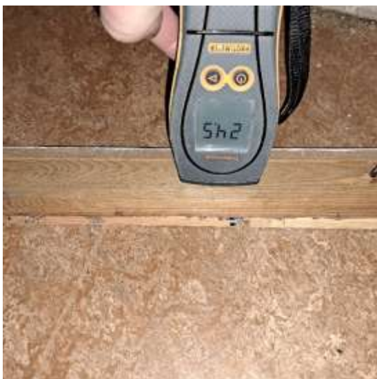
Figur 4 Förhöjda fuktnivåer i golvsockel mot burspråk.
