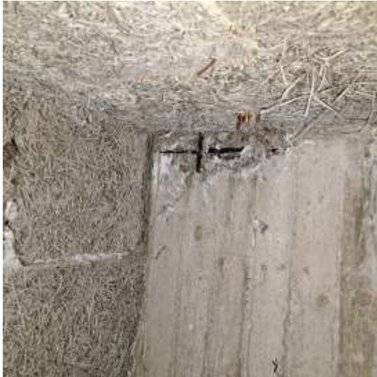
Figur 2 Armeringssprängning och saltutfällningar.
