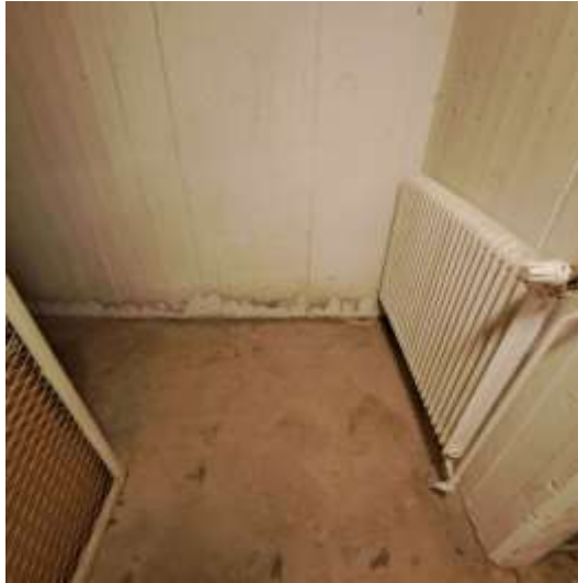
Figur 1 Spår av fuktuppsug i motfyllda väggar.
