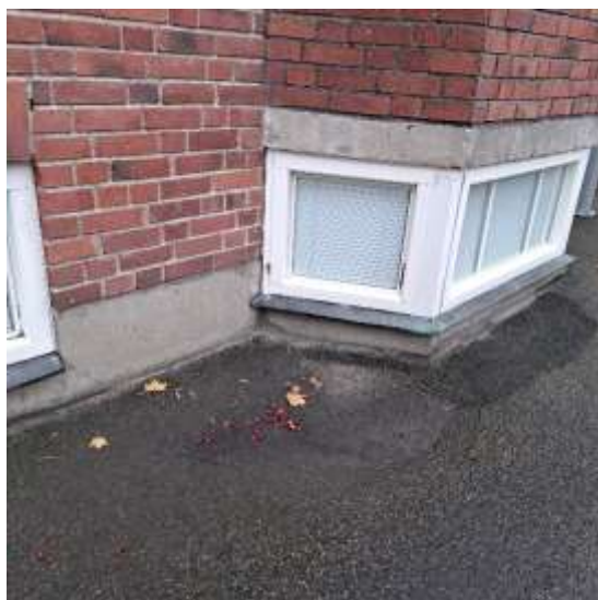
Figur 5 Skålbildande sättning i asfalt utanför burspråk.
