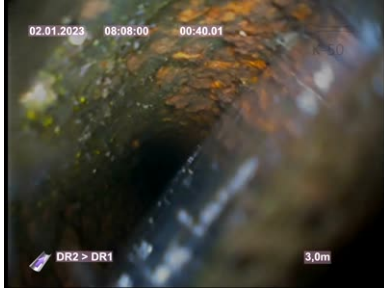
Bildnamn: 3_1_A, Videotid: 40s Vattenansamling 3. Medför en vattennivå som är från 15 % - 30 % av rörets invändiga höjd.
