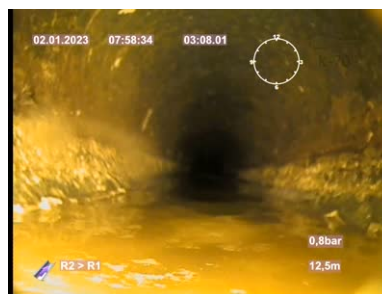
Bildnamn: 5_8_A, Videotid: 188s Vattenansamling 2. Medför en vattennivå som är från 5 % och upp till 15 % av rørets invändiga höjd.
