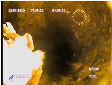
Bildnamn: 1_3_A, Videotid: 93s Främmande föremål 1. Reduktion av rörets tvärsnittsarea som är mindre än 5 %.
