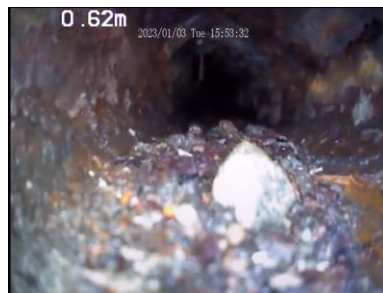
Bildnamn: 8_2_A, Videotid: 8s Sediment 2. Reduktion av rörets tvärsnittsarea som är från 5% och upp till 15%, annan .
