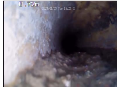
Bildnamn: 21_2_A, Videotid: 8s Sediment 2. Reduktion av rörets tvärsnittsarea som är från 5% och upp till 15%, annan .
