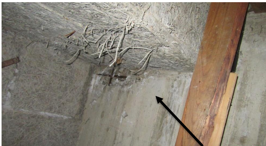
BILD 1. Synlig armering med armeringskorrison under entrétrappan i hus 62. Vid undersökningstillfället var betongkonstruktionen torr.
