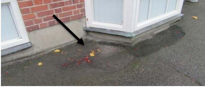
BILD 2. Sättningar i asfalt utanför källarvägg i hus 62.
